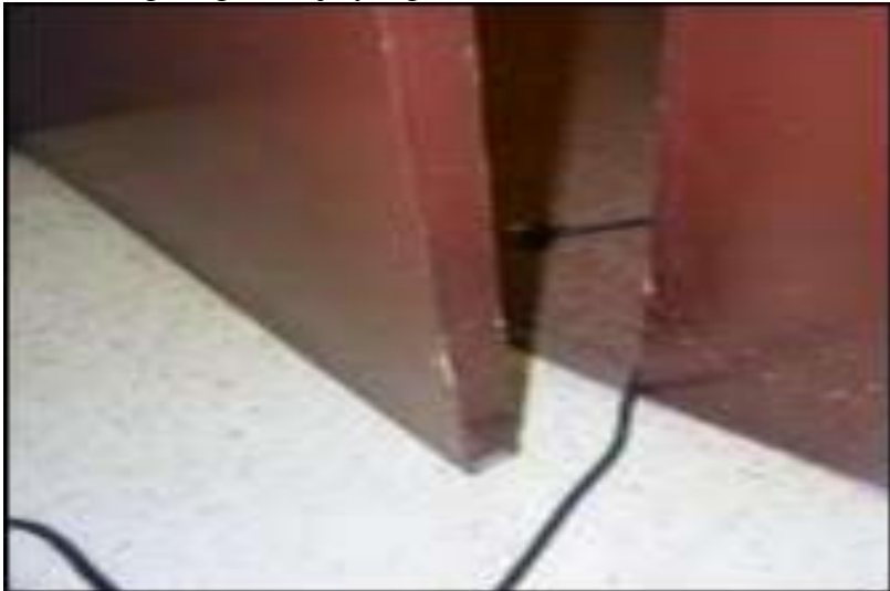
Gambar 2.5 Kondisi lingkungan kerja yang tidak aman
